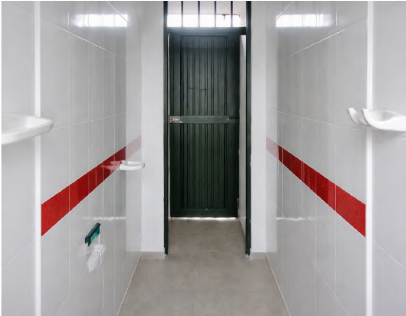
Imagen 33. Filtro sanitario ingreso a granja.
