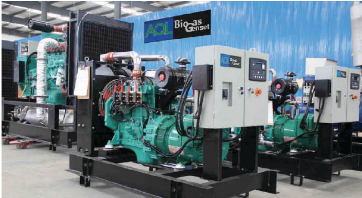
Ilustración 2. Motor generador a biogás
