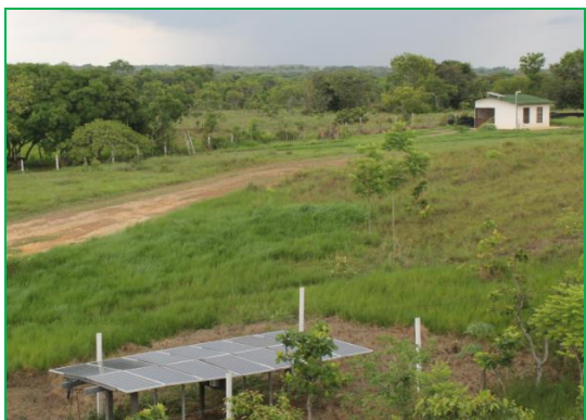
Imagen No.7 Sistema de paneles solares para el bombeo de agua subterránea en granja porcícola.
