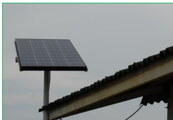
Imagen No.9 Panel solar para el autoabastecimiento doméstico de energía eléctrica.
