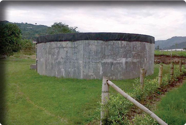
ILUSTRACIÓN 21 ▶ Tanque de agua
